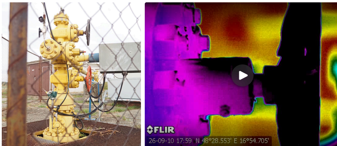
Obr. 2: Netesné ústie vrtu – vrt GaZ55 v obci Gajary [ odkaz na video ]
