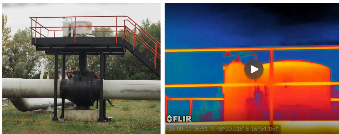
Obr. 1: Ventil (zariadenie navrhnuté na odľahčovanie) – regulačná stanica 1 Vysoká pri Morave [ odkaz na video ]
